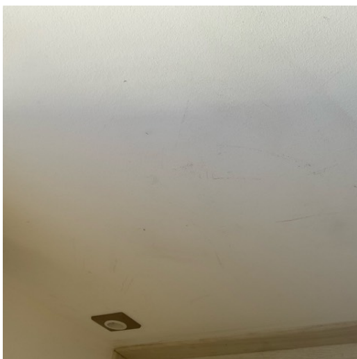
CHAMBRE 2 MUR A PEINTURE
