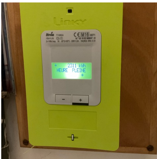
COMPTEUR ÉNERGIE HEURES PLEINES PALIER
