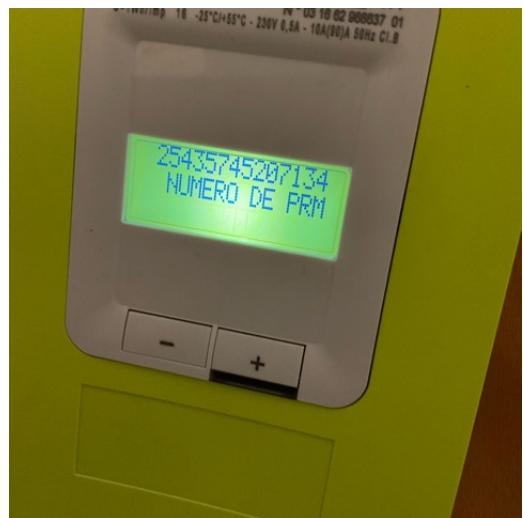
COMPTEUR ÉNERGIE HEURES CREUSES PALIER
