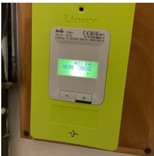
COMPTEUR ÉNERGIE HEURES CREUSES PALIER
