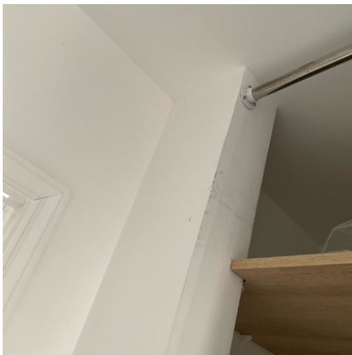
CHAMBRE 1 MUR A PEINTURE
