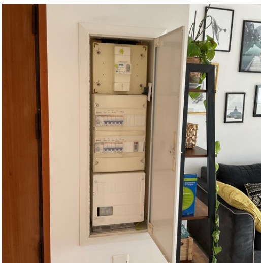
ENTRÉE INVENTAIRE TABLEAU ÉLECTRIQUE
